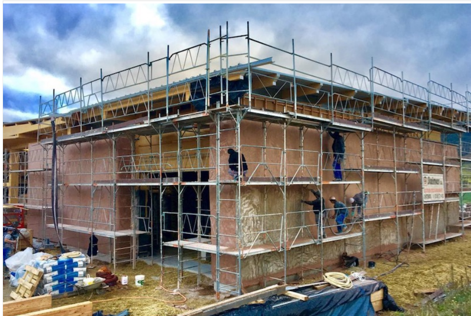
La construction imaginée par Jean pendant ses études d'ingénieur en viticulture, a été réalisée avec un architecte spécialiste des matériaux biosourcés, Christophe Köppel du cabinet Architecture et Paysages à Strasbourg. © Achillée.
